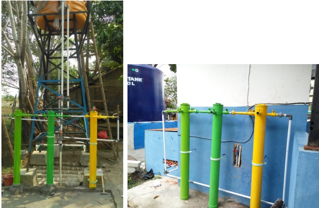
Gambar Model Housing Filter Sederhana yang telah dipasang di Kampung Pintu Air, Desa Kohod, Kabupaten Tangerang, Provinsi Banten
